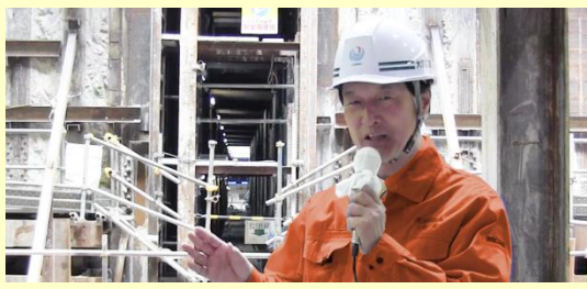
圏央道は、国道17号の下にトンネルを掘る工事が最新のシールド工法で進められており、工事は着実に進んでいます。
