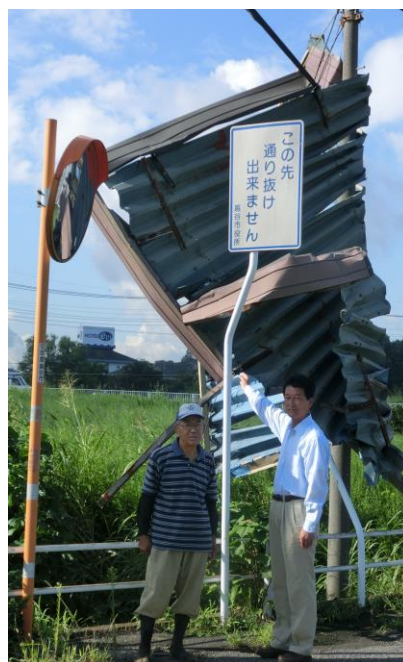
越谷市内被災現場
